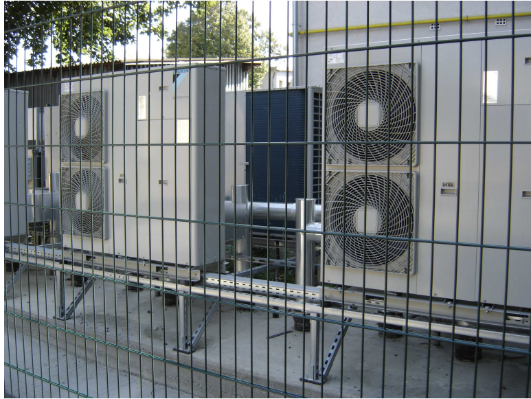
A G1 épületben alkalmazott hőszivattyúk
